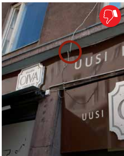
Kuva 58. Pinta-asennukset häiritsevät kokonaiskuvaa.
