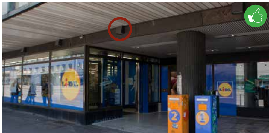
Kuva 51. Siisti, julkisivuun integroitu valaistus. Valaisimet on koteloitu huomaamattomasti julkisivuun.
