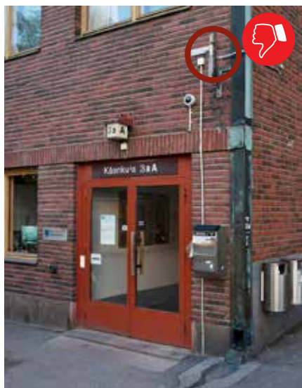
Kuva 60. Usean järjestelmän kaapeloinnit aiheuttavat sotkuisen sekamelskan.
