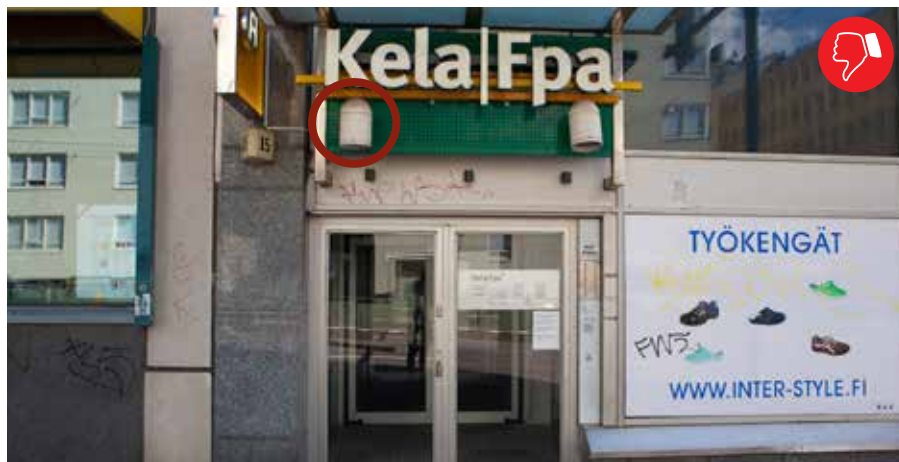
Kuva 52. Asennus on epäsiisti ja valaisimet turhan isot. Ne on myös suunnattu kulkijaa häikäisevästi.
