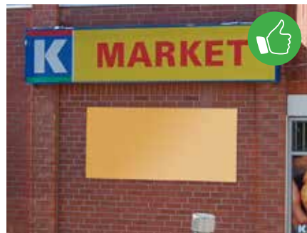
Kuva 93. Laadukkaampi vaihtoehto olisi esim. levykyltti asennettuna rakennuksen linjojen mukaisesti.
