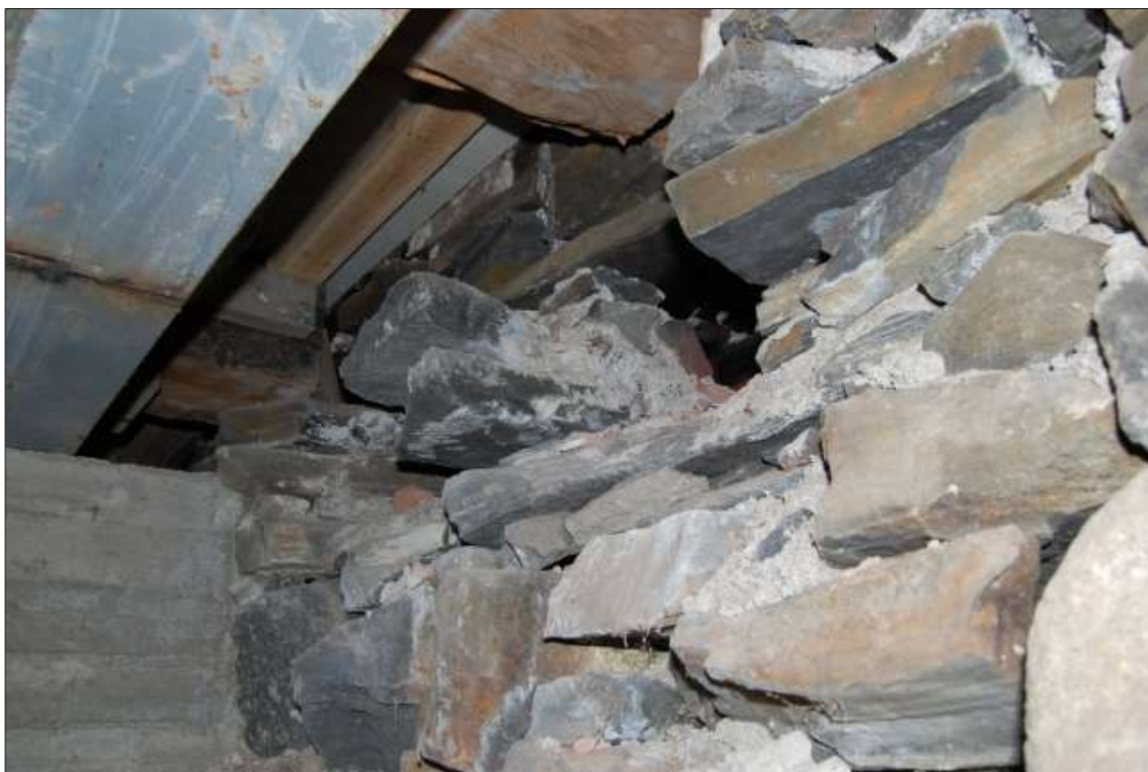
Makasiinin rossipohjan pohjoispäätä 24.10.2012. Lattiavasojen päät eivät lepää enää kivijalan päällä. Kuvassa pienempää liuskeista kivijalkaa, keskellä tuuletuskolo. MMT, 10_SLN_Riihisaari_24102012.jpg.
