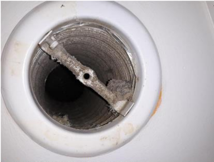
Kuva. Puhdistamaton poistoilmanvaihtokanava
